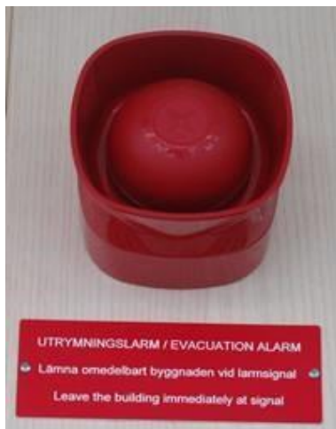
Fig. 1. Fire alarm siren
